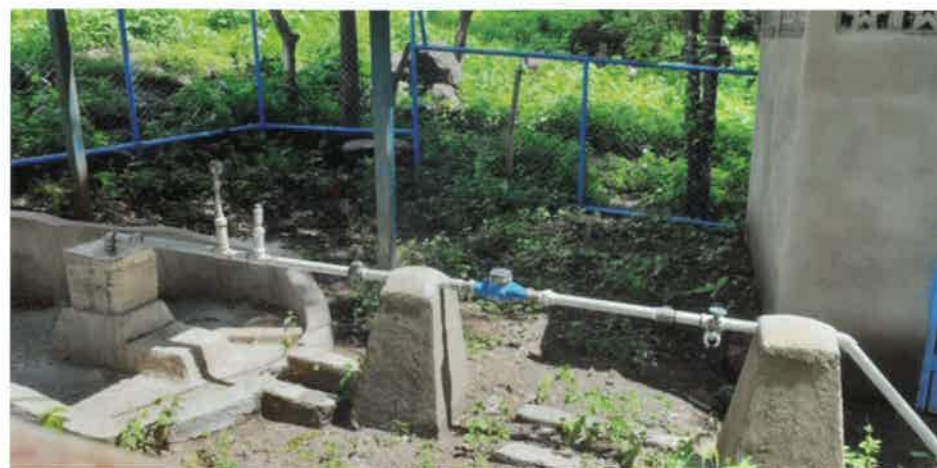
Installation de captage d'eau potable en milieu rural.
